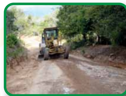
Trabajos en los caminos de Producción en el área norte de Penonomé
