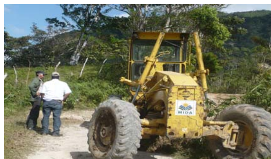
Reparación de pasos críticos en los caminos de producción del área norte de la provincia de Coclé.
