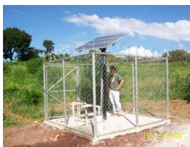
Sistemas instalados en funcionamiento, provincia de Herrera
