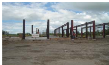
Inicio de la construcción de la Planta Post-Cosecha en la finca del Productor Alexis Aparicio, Comunidad del Guásimo, prov de Chiriquí .
