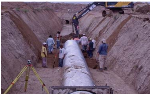
Líneas de aducción hidráulicas
