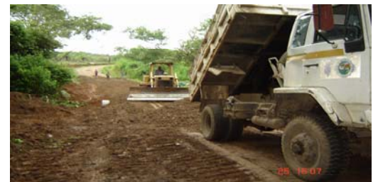
Rehabilitación de camino de la comunidad de El Bale distrito de Núrúm provincia de Veraguas donde se benefician más de 1000 personas del área
