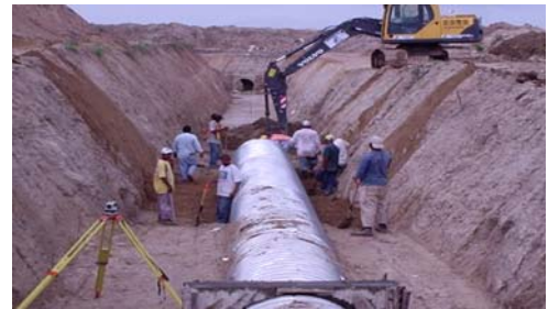
Tubería de aducción para transporte del agua de riego hacia los canales de principales en el sistema de Riego Lajas en el distrito de Penonomé.
